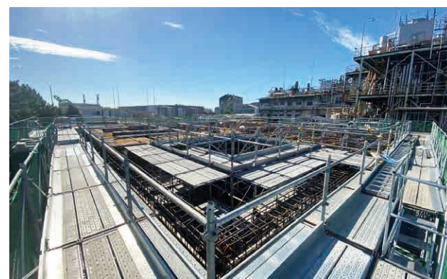
大八化学工業㈱ 排水処理設備
